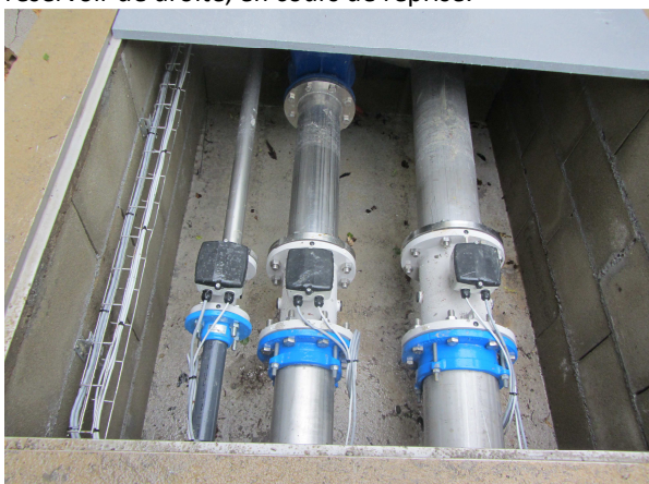
↑ Débitmètres de sectorisation sur le réseau surpressé et les départs des réseaux de 150 et 200 mm.
