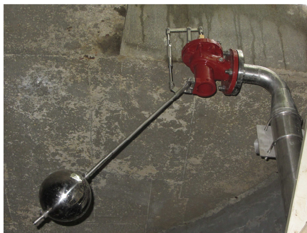
↑ Détail du nouveau robinet d'ouverture/fermeture de l'alimentation de la bache de Lafforgue (Assat).
