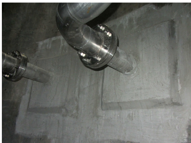
↑ Détail des reprises d'hydraulique inox en traversée de parois de la bache de la station de reprise de Lafforgue.
