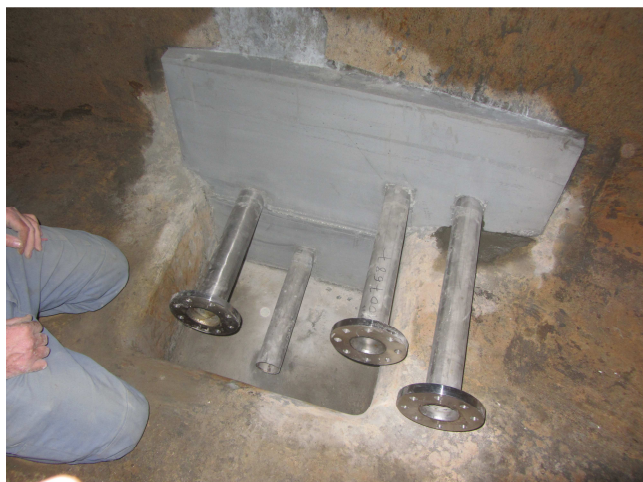
↑ Réhabilitation en cours de l'hydraulique en inox avec reprise de parois côté intérieur de la bache de reprise de Carrérot (Gélos).
