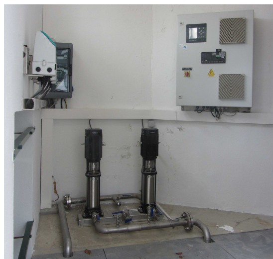
↑ Groupe de surpresseurs après réhabilitation de la chambre de vannes.
