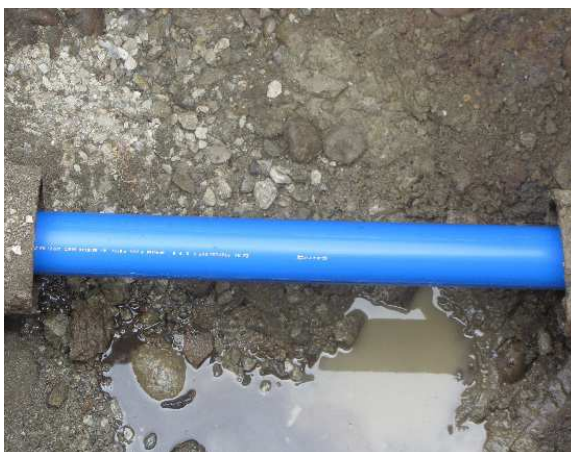
Intégration du tube en PEHD de 75 mm dans le fourreau en fonte de 150 mm (B d de Gaulle à Lons).
