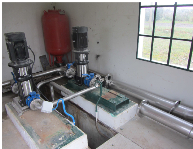
↑ Groupe de pompes de la chambre de vannes de la station de reprise de Lanot (GAN), en cours de réhabilitation.
