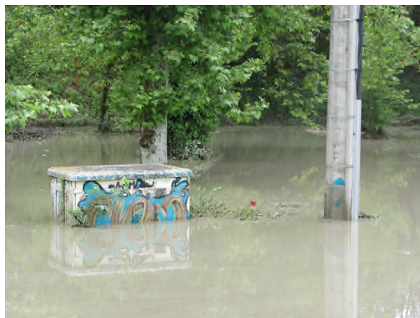
Point triple d'alimentation d'ErDF encore inondé au lendemain de la crue à Mazères-Lezons.
