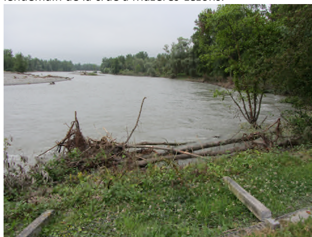
Clôture de la station d'alerte à Meillon endommagée, avec recul de la saligue (-80 ml) située en amont du site.
