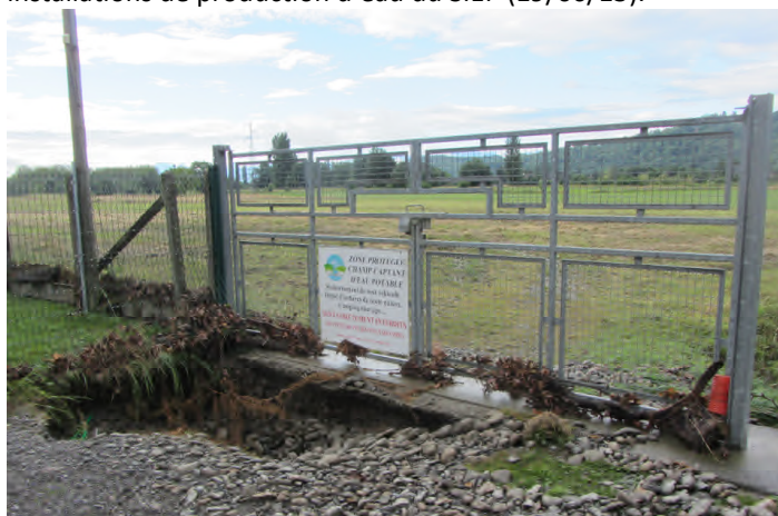
Une des nombreuses excavations de terres dues à la force érosive du gave en crue sur la plaine de Mazères-Lezons.
