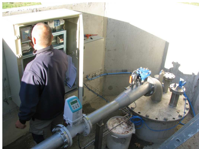
Instrumentation et paramétrage des équipements du puits « P8 ».
