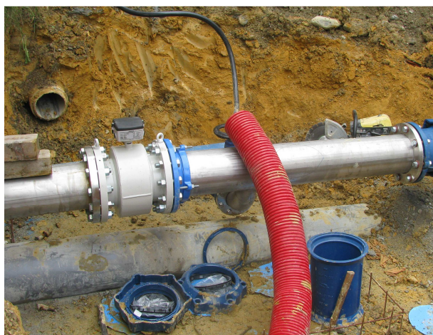
Refoulement en DN 200 mm et débitmètre en sortie de RIANT.
