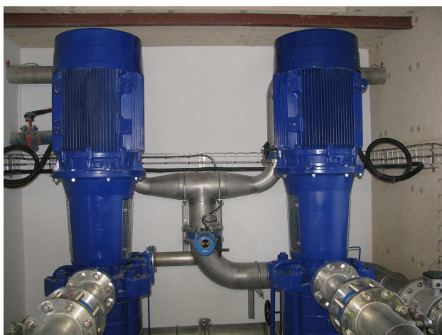
Nouveaux groupes de pompage de RIANT (100 m 3 /h à +170 m).
