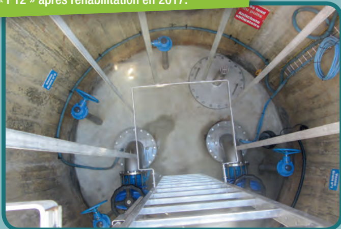
Intérieur du puits de production d'eau potable « P12 » après réhabilitation en 2017.
