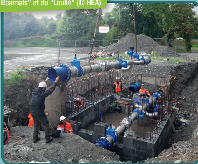
Pose des nouveaux tronçons équipés des conduites du "Nid Béarnais" et du "Loulie" (© HEA).
