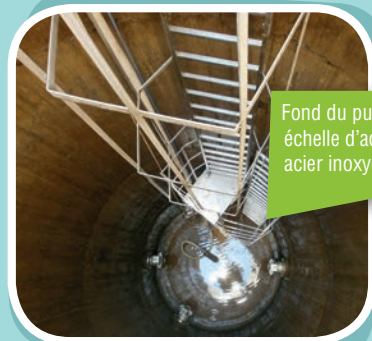
Plateforme intermédiaire en béton et hydraulique en acier inox, en cours de pose.
