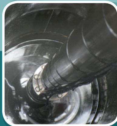
Vue intérieure du puits P17, en fonctionnement depuis 2001.
