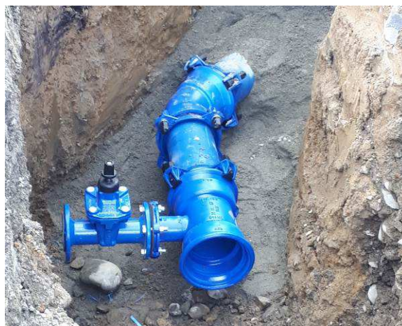
↑ Té et vanne en fonte sur conduite de 150 mm à Jurançon.
