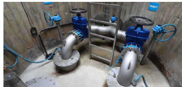
Des puissantes pompes électriques sont installées dans les puits de forage du champ captant. © MARC ZIRNELD
