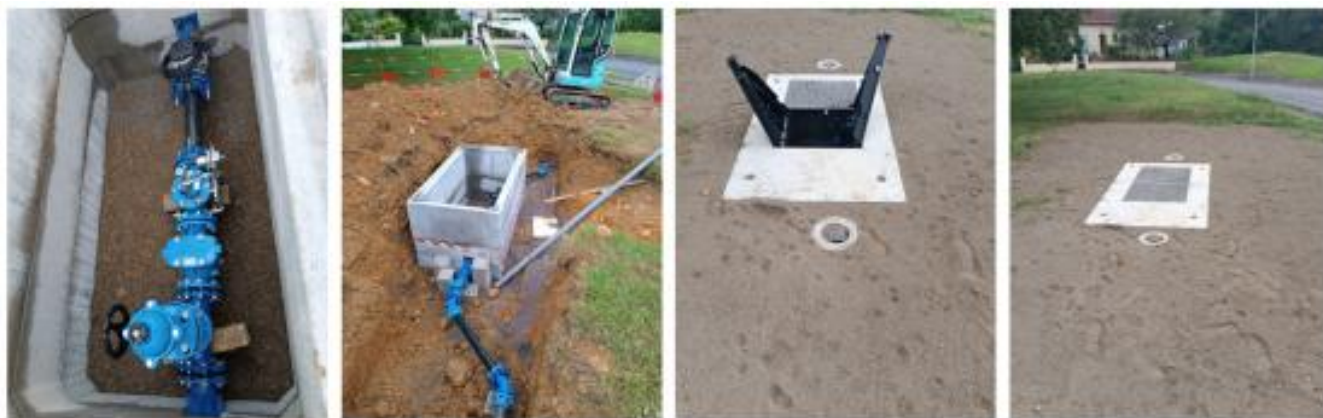
Figure 6: Exemple d'ouvrage de stabilisation de pression et de comptage à Gan
